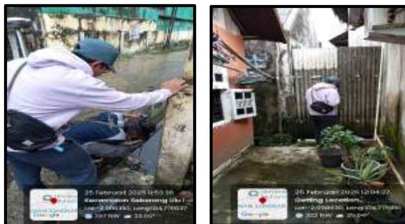
Gambar 4.1 Saluran yang Dipenuhi Endapan dan Tertutup Bangunan
